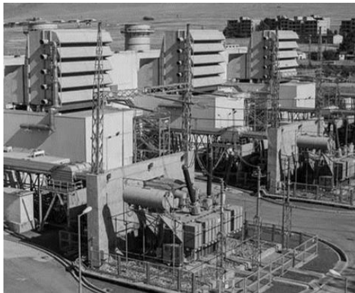
تصویر ۵: جداسازی کالبدی ترانسفورماتورها از دیگر بخش‌های همجوار با فنس و دیوار بتنی؛ مأخذ: نگارنده
